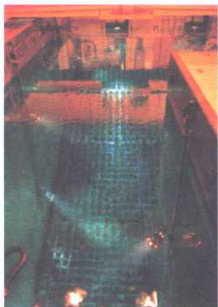
Piscina de combustible gastado
